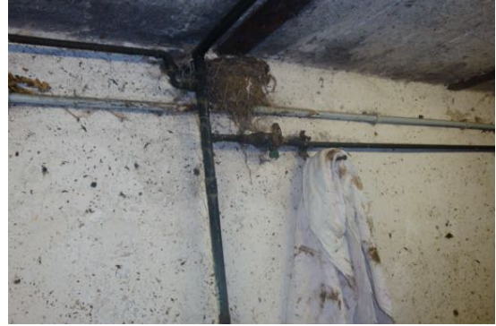
Abb. 3: Nest auf Rohrleitung
