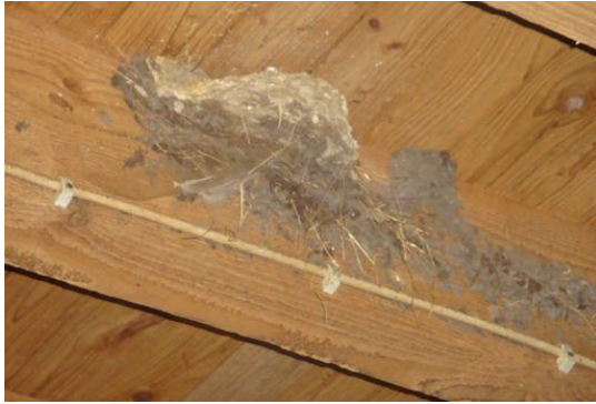
Abb. 2: Nest am Holzbalken
